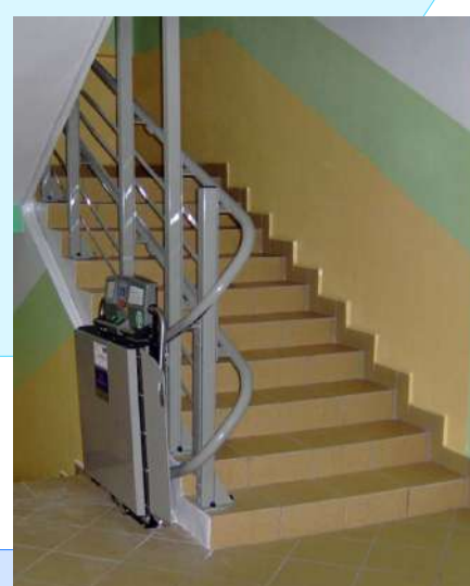
Fijación en el hueco de la escalera
